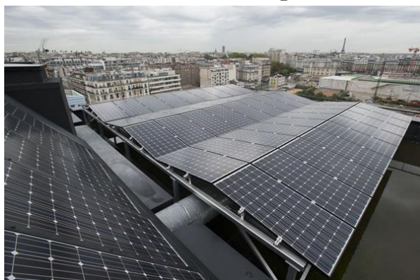
Centrale solaire parisienne - Photo Marc Verhille
